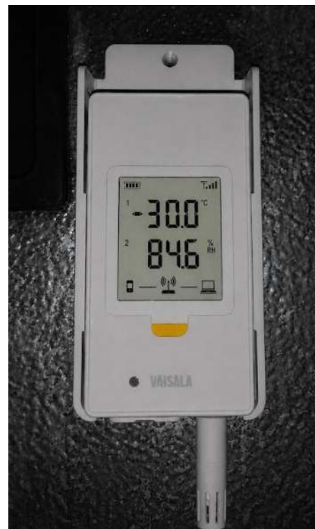
Fig. 4. Datalogger de humedad y temperatura
