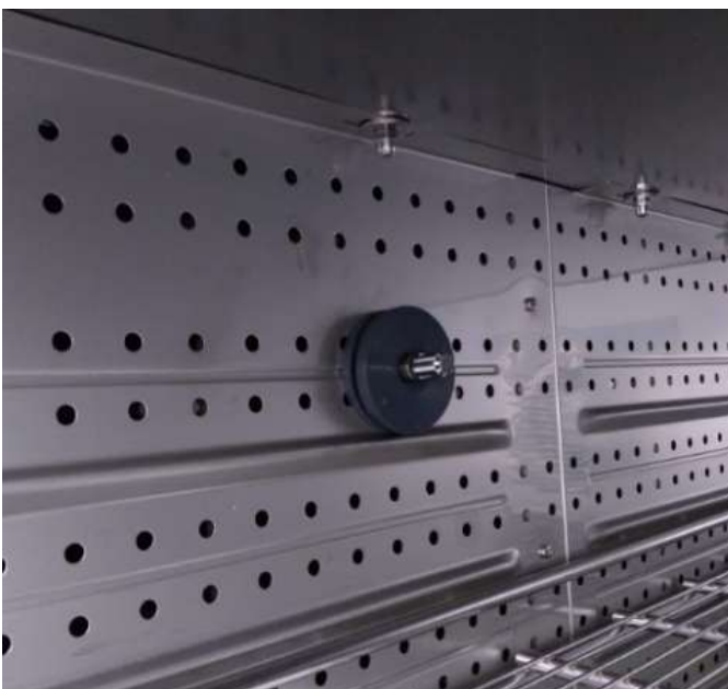
Fig. 3. Sensores para medir humedad relativa y temperatura
