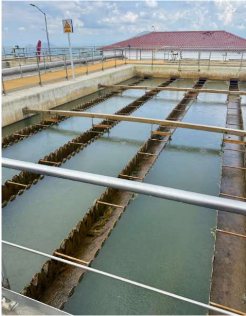
Fig. 5. Agua en tratamiento
