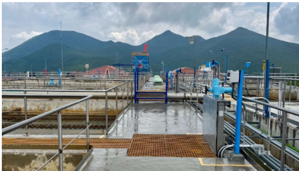
Fig. 6. PTAP, Acueducto II
